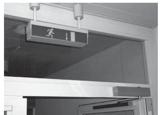
Bild 6: Beispiel einer Notbeleuchtung
